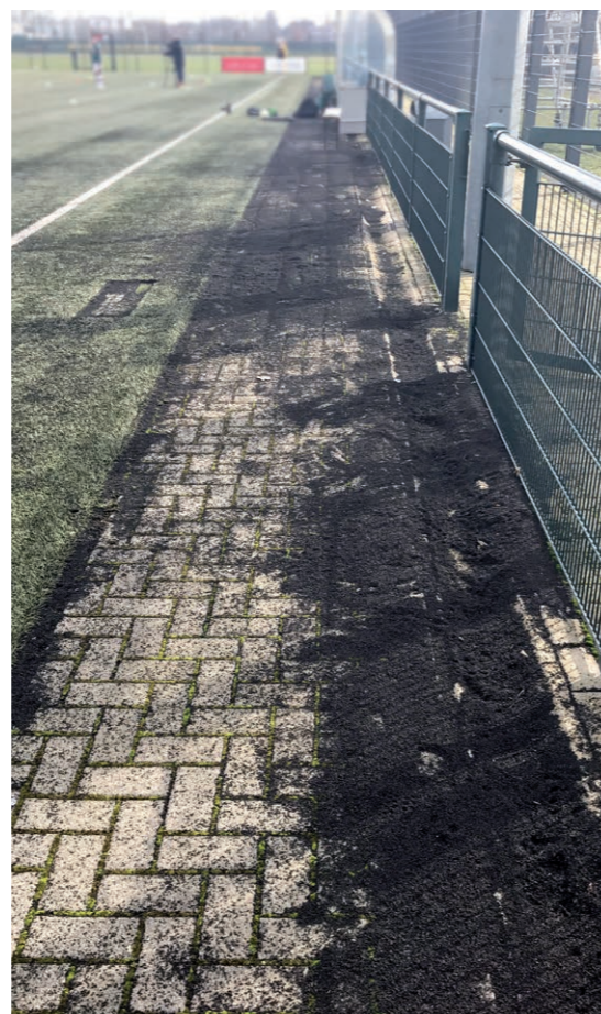
Abb. 9_Durch Schneeräumen ausgetragenes Granulat
